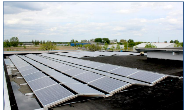
Abb. 1 Photovoltaikanlage auf Allresist-Dach
