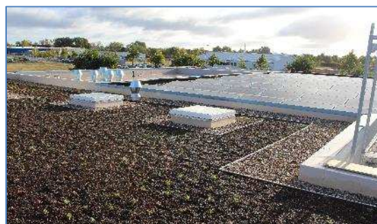
Abb. 2 Wachsendes Gründach, dahinter die Photovoltaik-Anlage
